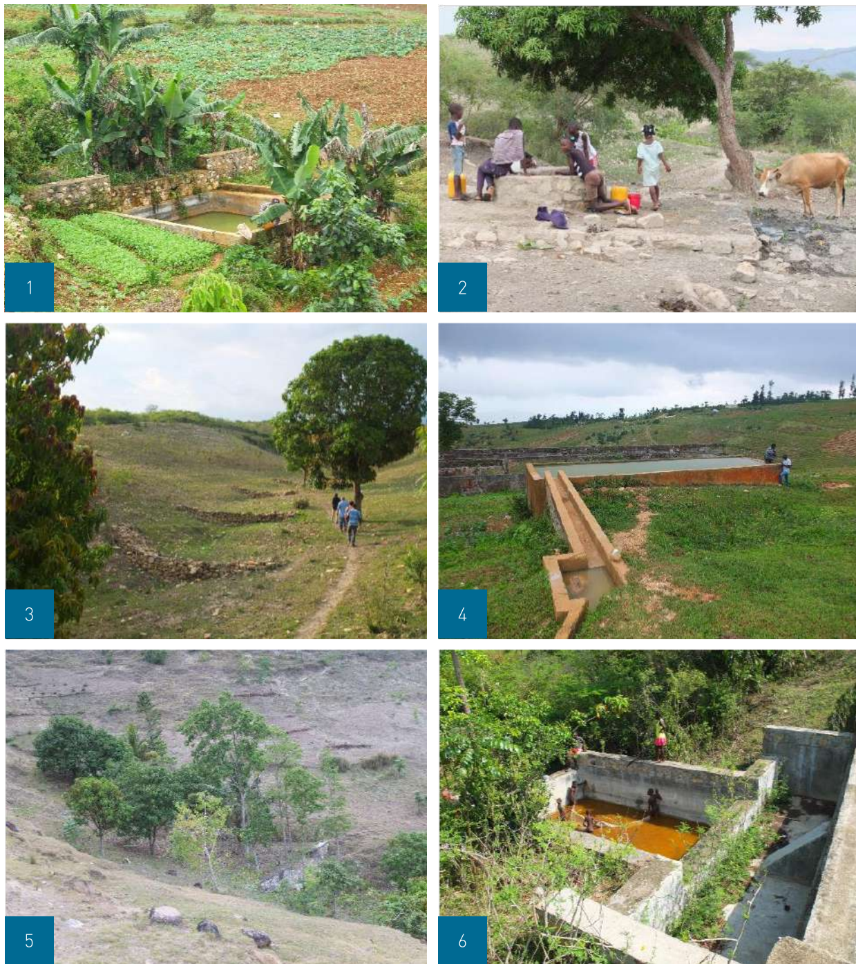
1 : Seuil bassin et culture maraîchères, Ravine Diable, Salagnac, Avril 2019 2 : Puits à usage domestique et agricole, Gros Morne, Mai 2019 3 : Seuil en pierre sèche, Gros Morne, Mai 2019
